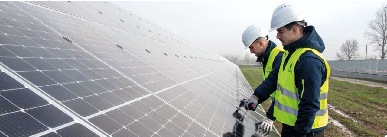
Impianto fotovoltaico realizzato da Renovit per Solat presso il sito produttivo di Leno (BS)
